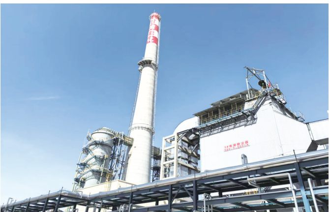
图为甘肃能化锅炉电袋除尘、烟气脱硫系统正在调试。 记者 李峰 摄
