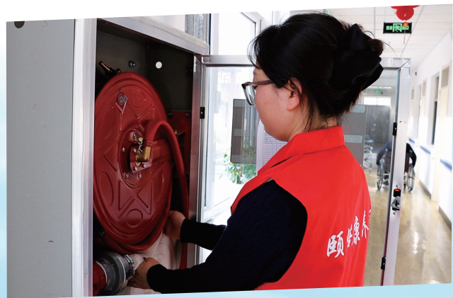
▲金川区桂林路街道综合养老服务中心工作人员检查消防设施设备。 记者 李新宇 摄
