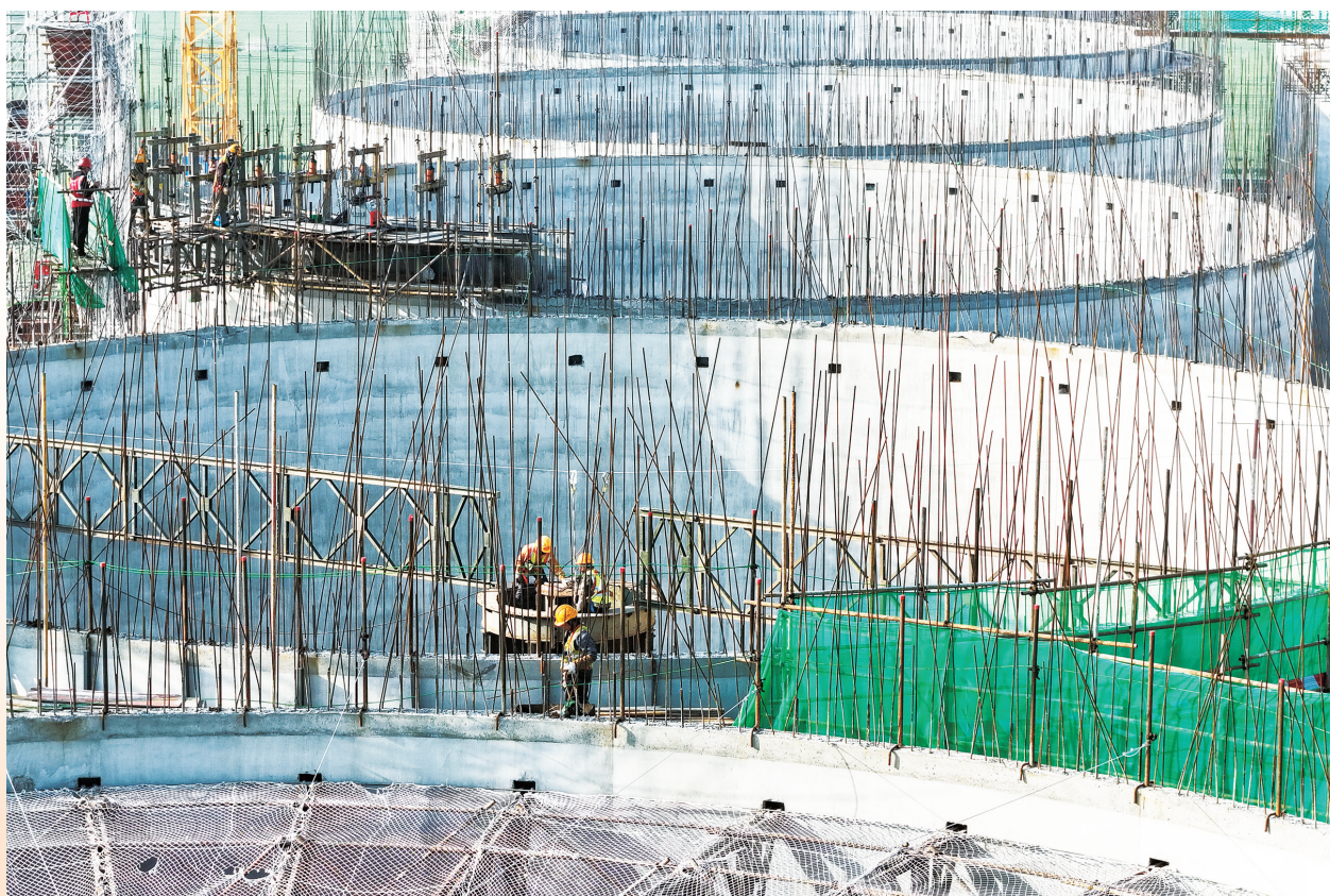
4月25日,工人在泗洪县归仁镇中央储备粮宿迁直属库仓储项目建设工地紧张施工(无人机照片)。
